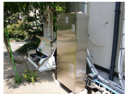
ヒートポンプ(右)と一次側ヘッダ(左)
